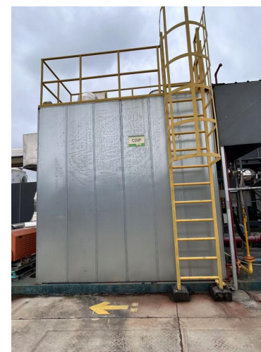
图 2-7.4 B 栋高浓度有机废气治理设施-活性炭吸附(脱附+CO 催化燃烧)
