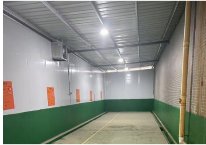
图 2-7.55 项目危险废物暂存间 (GF-010115)
