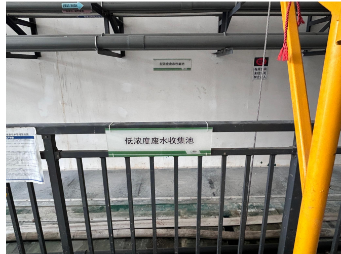
图 2-7.37 污水厂废水预处理设施（2#预处理设施集水池）
