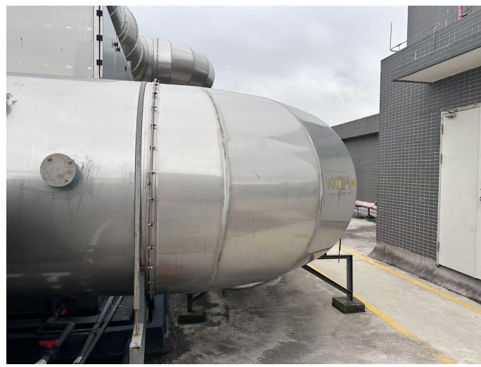
图 2-7.8 B 栋低浓度有机废气收集管道
