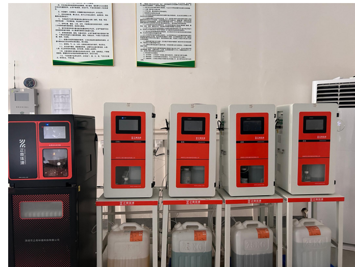
图 2-7.50 含镍废水排放口（WS-004048）在线监控设备
