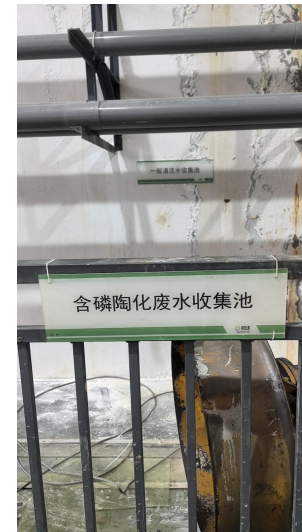
图 2-7.39 污水厂废水预处理设施（4#预处理设施集水池）
