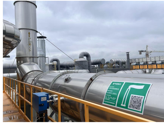
图 2-7.6 B 栋高浓度有机废气排放口 (FQ-008736)
