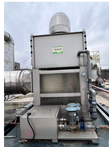
图 2-7.2 B 栋高浓度有机废气治理设施-气旋混动塔
