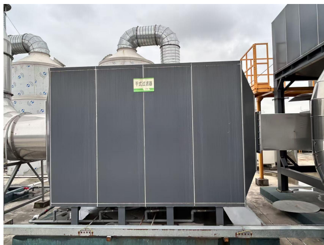
图 2-7.3 B 栋高浓度有机废气治理设施-三级干式过滤器
