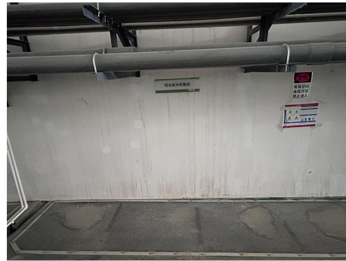
图 2-7.44 污水厂废水综合治理设施（pH 调节池+调整池）
