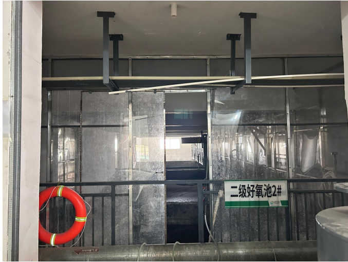
图 2-7.47 污水厂废水综合治理设施（二级 AO 池）
