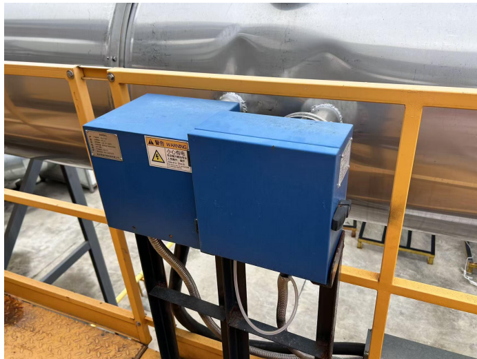
图 2-7.7 B 栋高浓度有机废气在线监测设备
