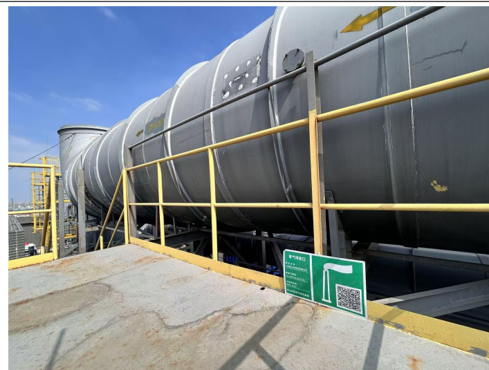
图 2-7.18 B 栋一般酸雾废气排放口 (FQ-008782)
