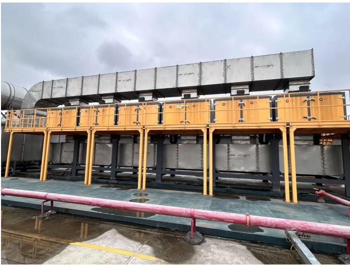
图 2-7.11 B 栋低浓度有机废气治理设施-活性炭吸附
