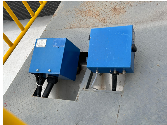
图 2-7.26 废气排放口 (FQ-008794) 对应在线监控设备
