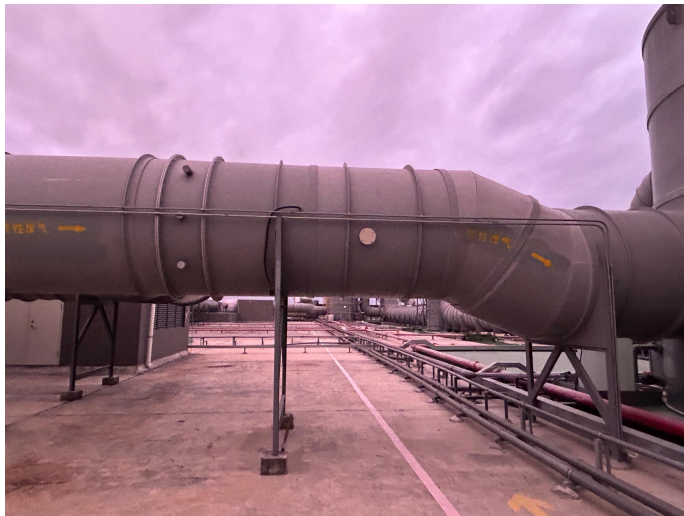
图 2-7.27 C 栋一般酸雾浓废气收集管道
