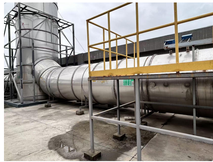
图 2-7.12 B 栋低浓度有机废气排放口 (FQ-008793)
