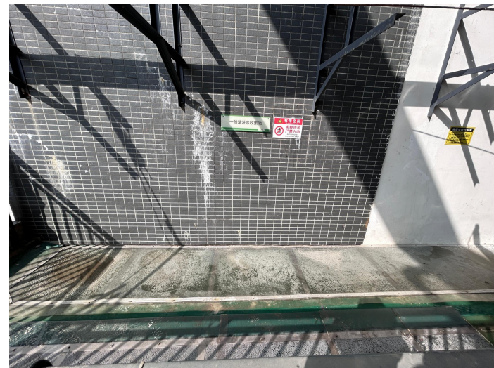
图 2-7.43 污水厂废水预处理设施（6#预处理设施集水池）
