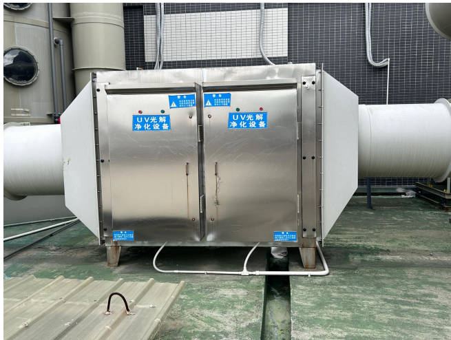
图 2-7.33 污水处理厂废气治理设施-UV 光解
