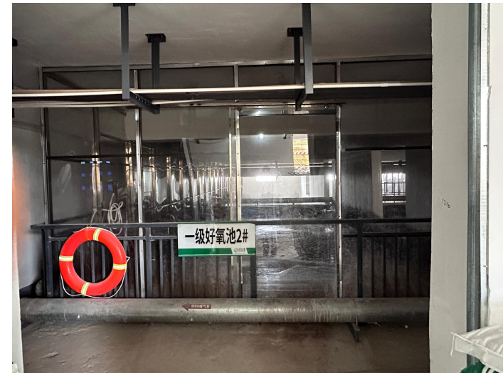
图 2-7.46 污水厂废水综合治理设施（一级 AO 池）
