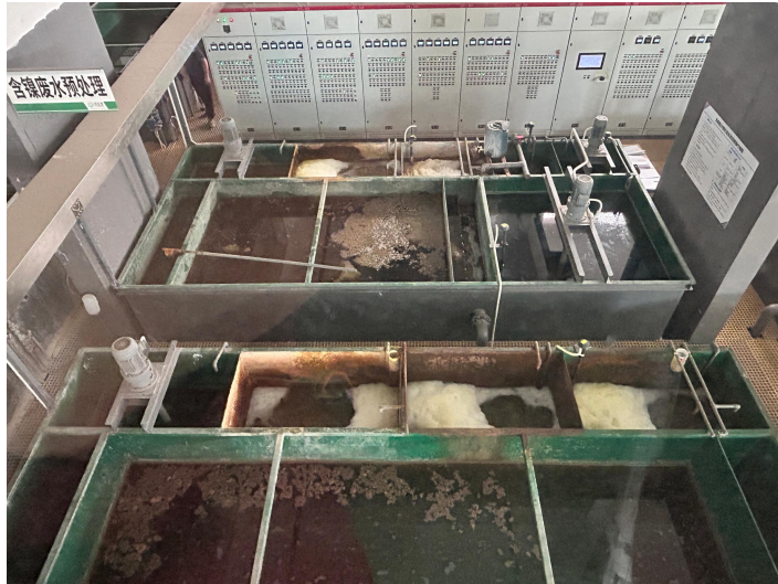
图 2-7.42 污水厂废水预处理设施（5#预处理设施）
