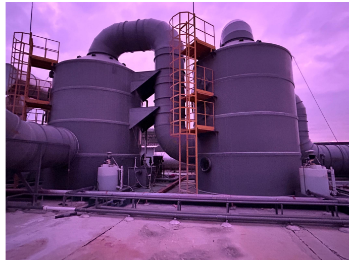
图 2-7.28 C 栋一般酸雾废气治理设施-碱液喷淋
