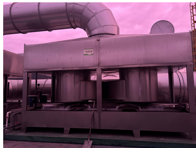
图 2-7.20 C 栋低浓度有机废气治理设施-气旋混动塔
