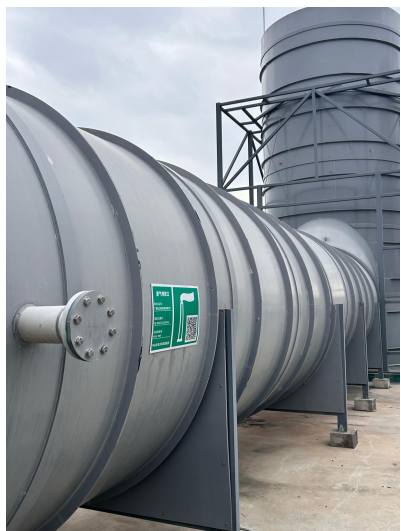
图 2-7.29 C 栋一般酸雾废气排放口 (FQ-008783)
