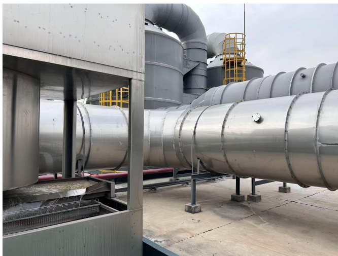
图 2-7.19 C 栋低浓度有机废气收集管道
