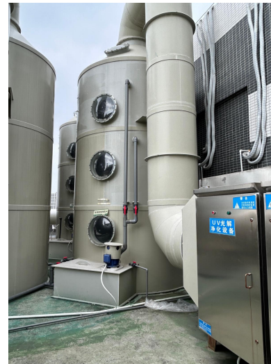
图 2-7.32 污水处理厂废气治理设施-生物洗涤塔
