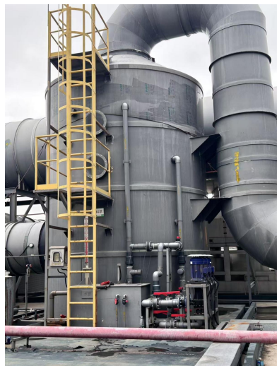
图 2-7.17 B 栋一般酸雾废气治理设施-碱液喷淋
