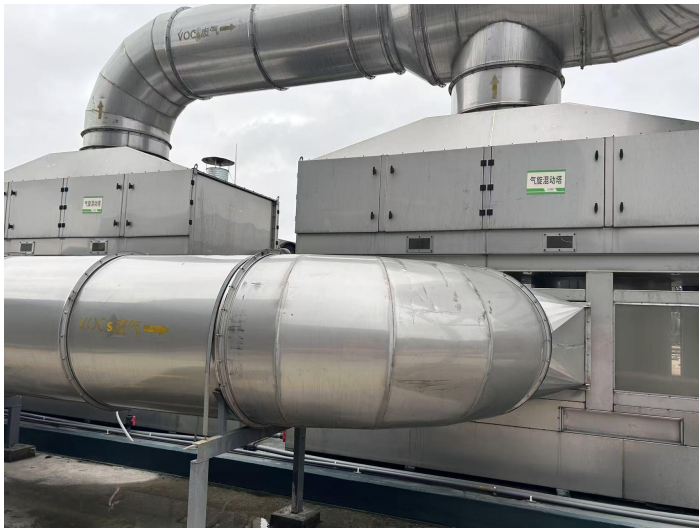
图 2-7.9 B 栋低浓度有机废气治理设施-气旋混动塔
