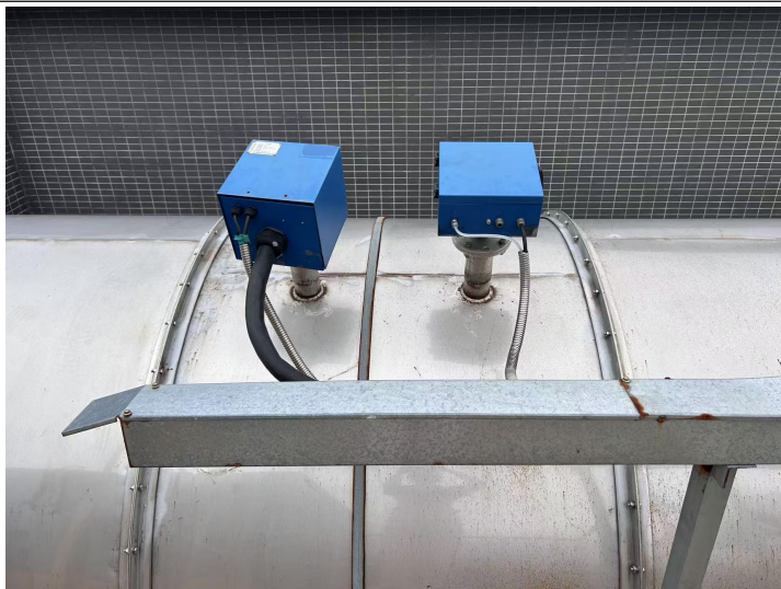
图 2-7.15 废气排放口 (FQ-008795) 对应在线监控设备
