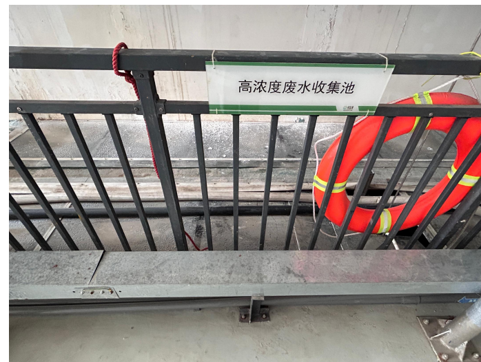
图 2-7.35 污水厂废水预处理设施 (1#预处理设施集水池)
