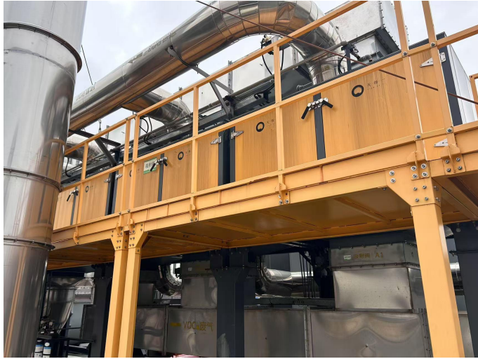
图 2-7.5 B 栋高浓度有机废气治理设施-活性炭吸附
