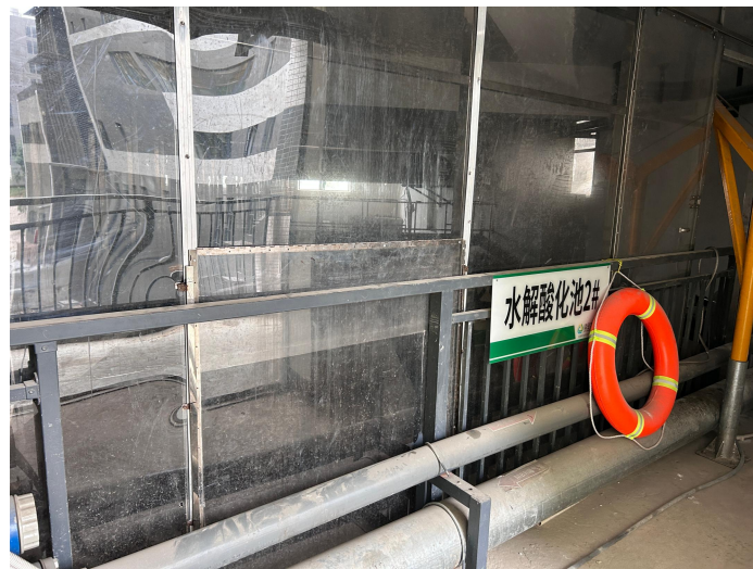
图 2-7.45 污水厂废水综合治理设施（水解酸化池）
