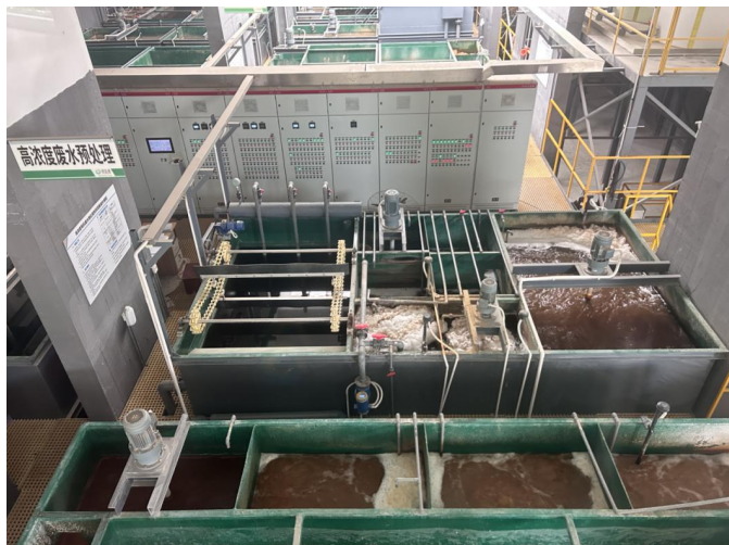
图 2-7.36 污水厂废水预处理设施（1#预处理设施）
