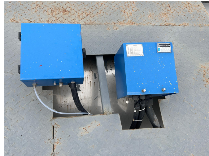
图 2-7.24 废气排放口 (FQ-008796) 对应在线监控设备
