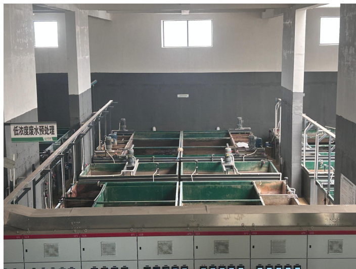
图 2-7.38 污水厂废水预处理设施（2#预处理设施）
