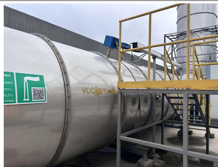
图 2-7.14 B 栋低浓度有机废气排放口 (FQ-008795)
