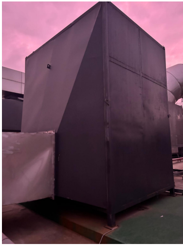
图 2-7.21 C 栋低浓度有机废气治理设施-三级干式过滤器
