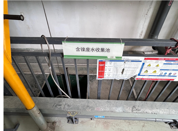
图 2-7.41 污水厂废水预处理设施（5#预处理设施集水池）
