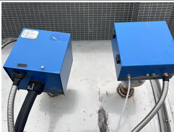
图 2-7.13 废气排放口 (FQ-008795) 对应在线监控设备
