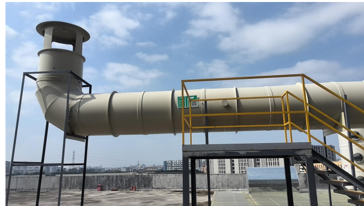
图 2-7.33 污水处理厂废气排放口 (FQ-008797)
