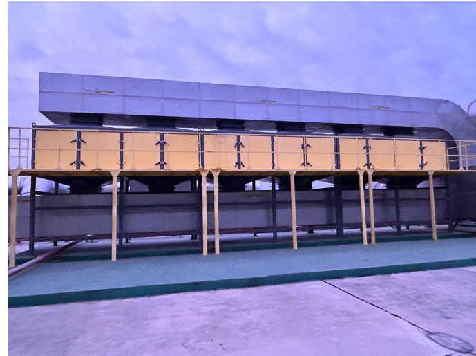
图 2-7.22 C 栋低浓度有机废气治理设施-活性炭吸附
