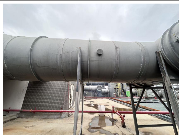
图 2-7.16 B 栋一般酸雾浓废气收集管道
