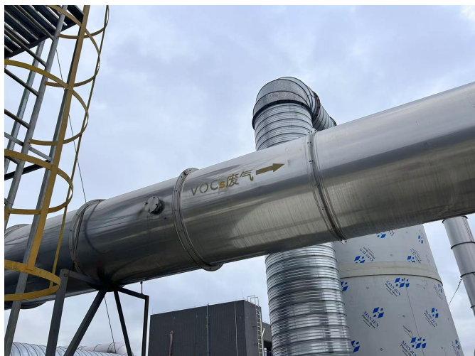
图 2-7.1 B 栋高浓度有机废气收集管道
