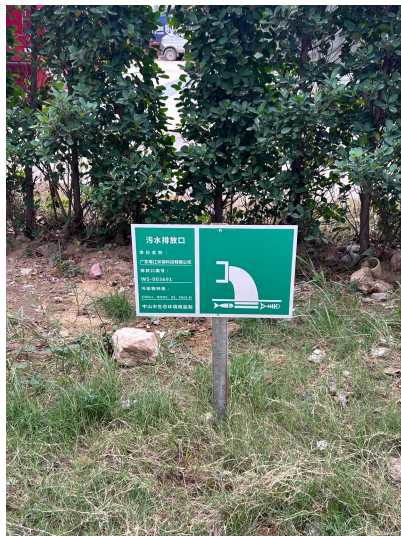
图 2-7.34 生活污水排放口 (WS-003691)
