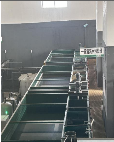
图 2-7.43 污水厂废水预处理设施（6#预处理设施）
